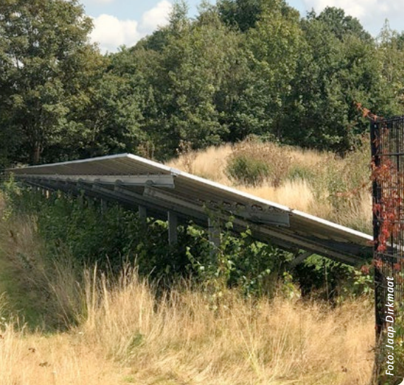
In het Solarpark De Kwekerij bij Hengelo is voldoende ruimte tussen de panelen ten behoeve van flora en fauna.
